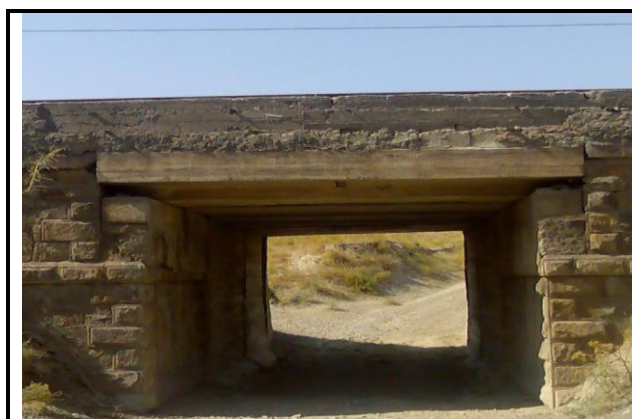
фото 1.1. Перегрузка внешней консоли плиты пролетного строения от наращивания борта балластного корыта
