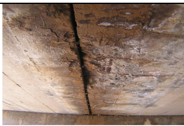
то 1.2. Нарушение водоотвода, коррозия бетона и арматуры
