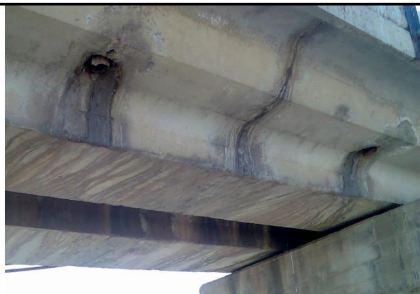
Фото 1.4. Неисправности водоотводных трубок, коррозия бетона и арматуры
