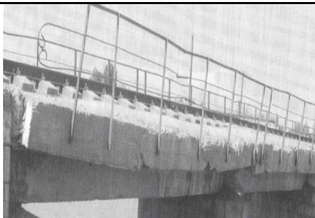
Фото 1.3.Провисания внешней консоли плиты от перегрузки
